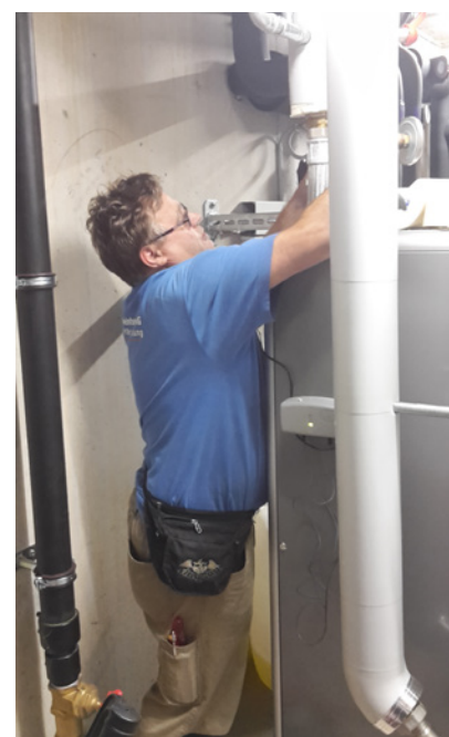
Ein Monteur sucht die Fehlerursache des Heizungsschadens
