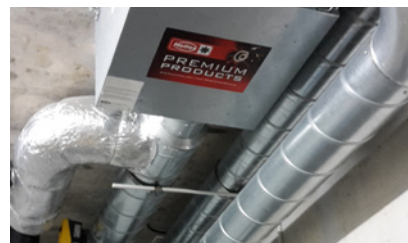
Kellerlüftung in Oberägeri
