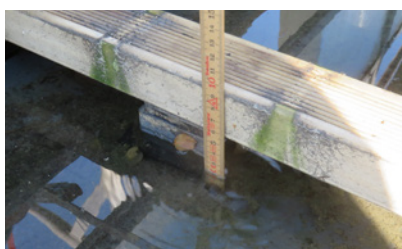
Stehendes Wasser auf der Terrasse
